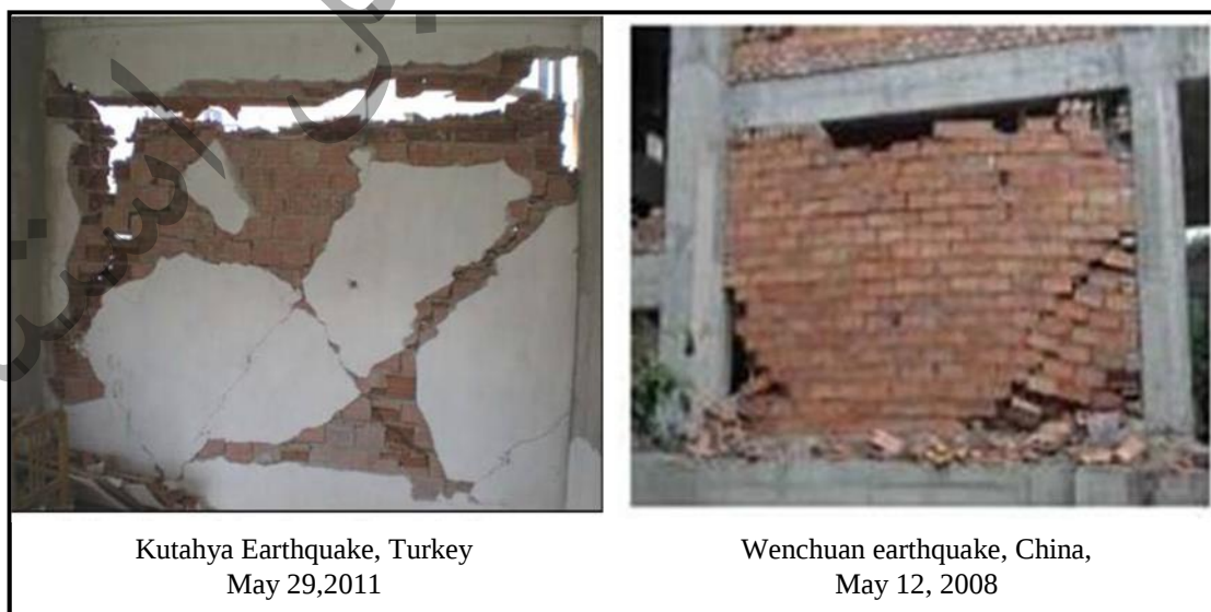
شکل ۱-۱۴- خرابی داخل صفحه میانقاب‌های رسی (سفالی) غیرمسلح در زلزله‌های کوتاهیا و ونچوان
