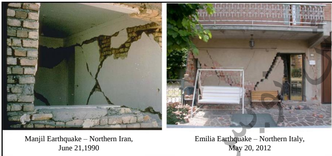
شکل ۱-۱۳- بروز ترک‌های قطری در دیوارهای بنایی غیرمسلح در زلزله‌های منجیل و امیلیا
